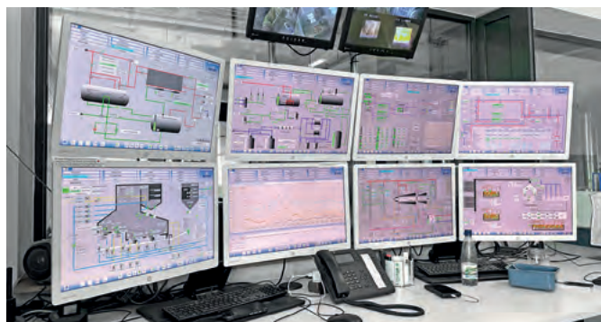
Kontrollfunktion: Seit der erfolgreichen Implementierung des EPOC-Boilers läuft ein Großteil der Anlagenregelung vollautomatisch
